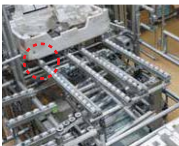
④ Stopper ไฟฟ้าปลดล็อก และลำเลียงชิ้นงานไหลไปข้างในสุด
