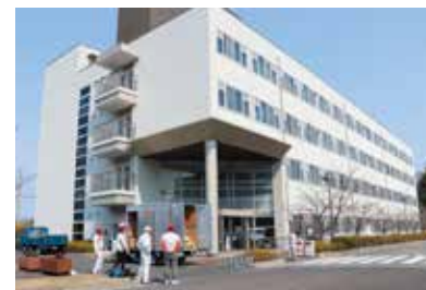
ロボットを設置した建物。扉などの間口が狭く搬入用の大型エレベーターもないため、現地組立での対応となった。
