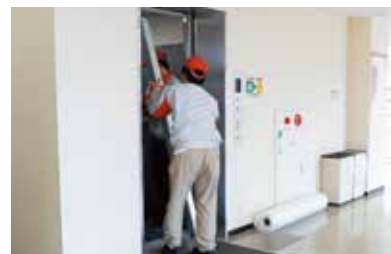
一般的な乗用エレベーターでも、設置場所がある建物の2階へと運ぶことができた。
